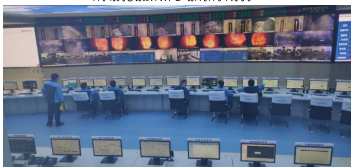
ห้องควบคุมระบบของโรงไฟฟ้า
