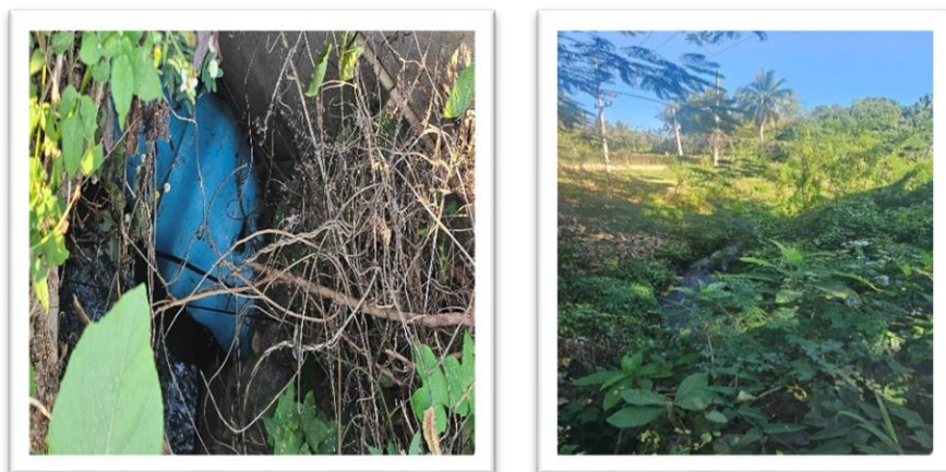
(แนวท่อส่งน้ำเดิมชำรุด)
