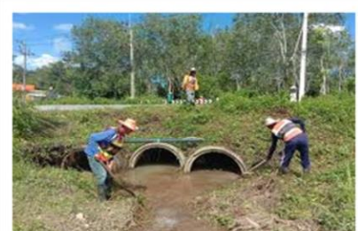
ทำจัดสิ่งขัดขวางทางระบายน้ำ
