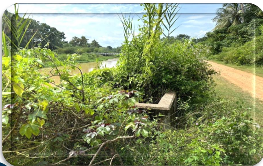
รูปภาพ ๑ ( ภาพท่อรับน้ำป่าก่อนดำเนินการ )
