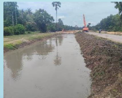
คลองระบายน้ำโคกอิฐ-โคกโน
